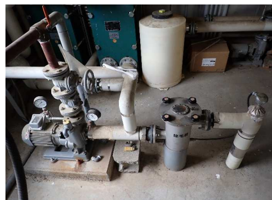
RP-3 : 露天風呂循環・濾過ポンプ
