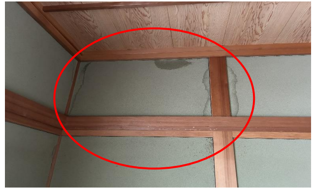
1F 和室 ⑥ 壁雨漏り跡
