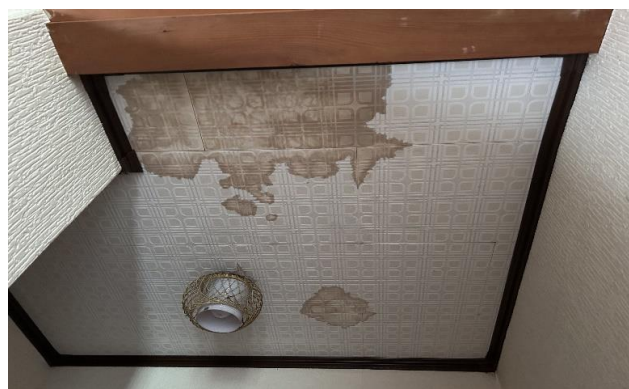
2F 廊下 ⑫ 天井 しみ
