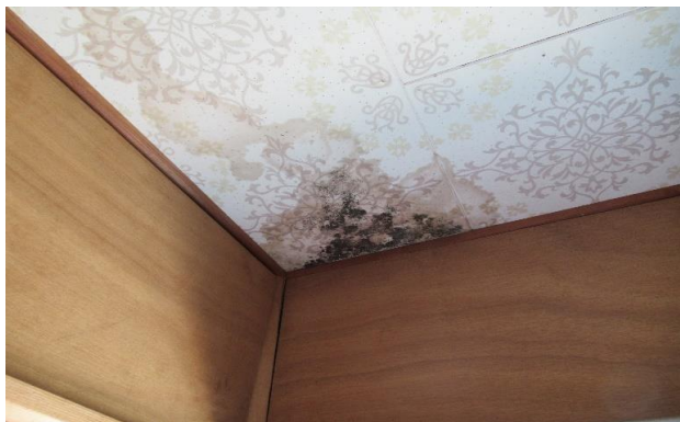
和室 ⑥ 天井 (2) 雨漏り
