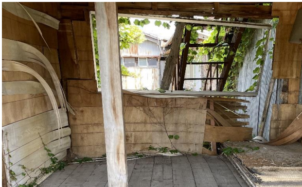
⑮ 窓・壁破損
