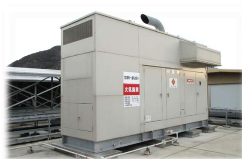
自家発電装置
