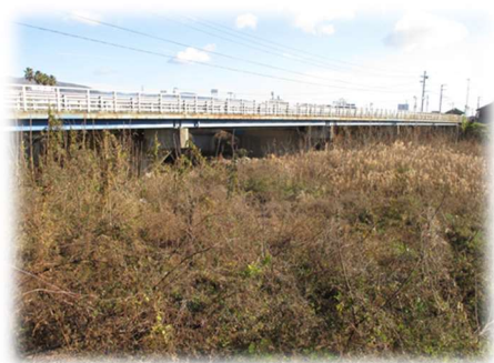
土砂が堆積した 伊沢谷川（下伊沢谷橋付近）
