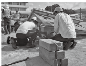
倒壊家屋からの救出【大俣小学校区】
