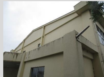
【外壁】ひび割れ
