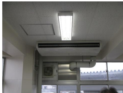
写真8：小中学校に設置された空調設備
