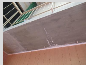
【内部仕上】ひび割れ
