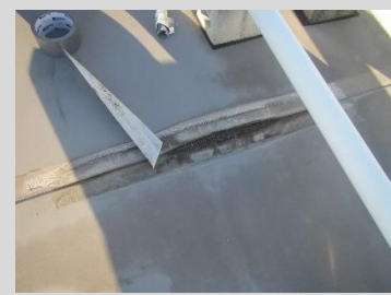
【屋根・屋上】 防水シートの剥離
