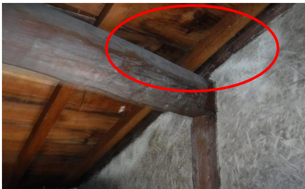
2F 天井 雨漏り跡
