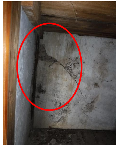
1F 押入 壁 雨漏り跡・隙間
