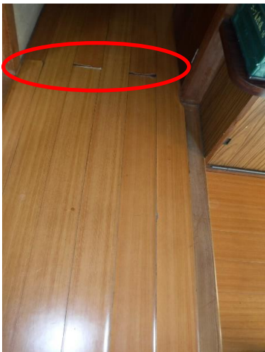
② 廊下 床はがれ
