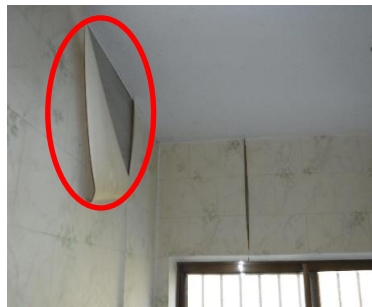
⑦ 洗面所 天井ひび・壁がみはがれ
