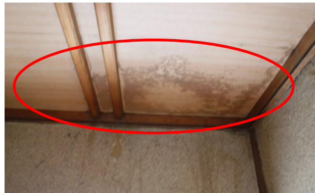
1F 廊下 天井シミ
