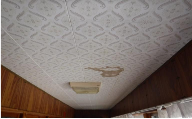
廊下⑥ 天井シミ
