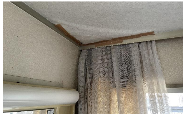
1F 台所 天井 雨漏り
