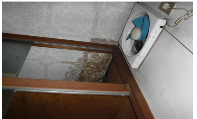
1F 店舗 ⑩ 天井雨漏り
