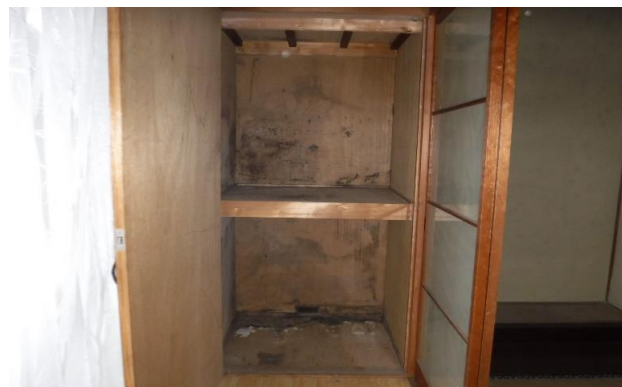
1F 廊下 ⑥ 押入雨漏り
