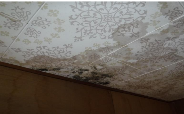
和室 ⑥ 天井 (1) 雨漏り
