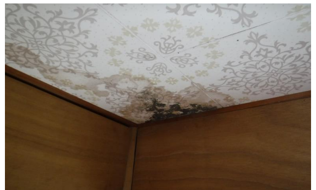
和室 ⑥ 天井 (2) 雨漏り
